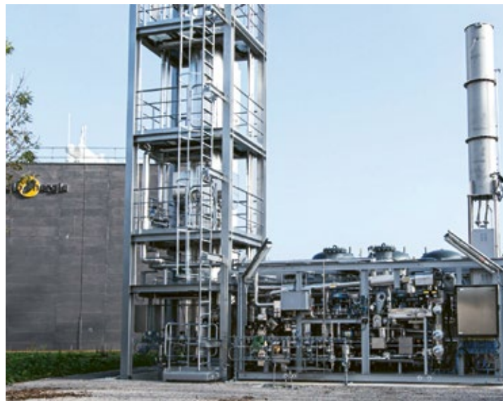
Centrale hybride d'Aarmatt, Soleure – permet le couplage sectoriel des réseaux de gaz, de chauffage à distance et d'électricité
